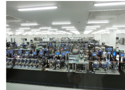
最新式空調設備のクリーンルーム
